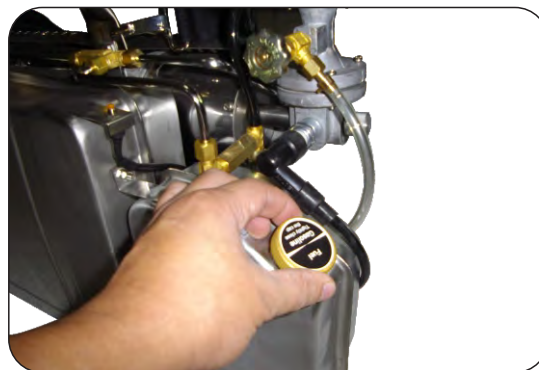
Tapa tanque combustible cerrada
